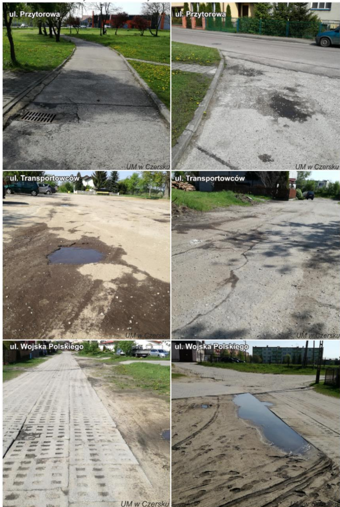
Ryc. 39. Ulice i chodniki w złym stanie technicznym
