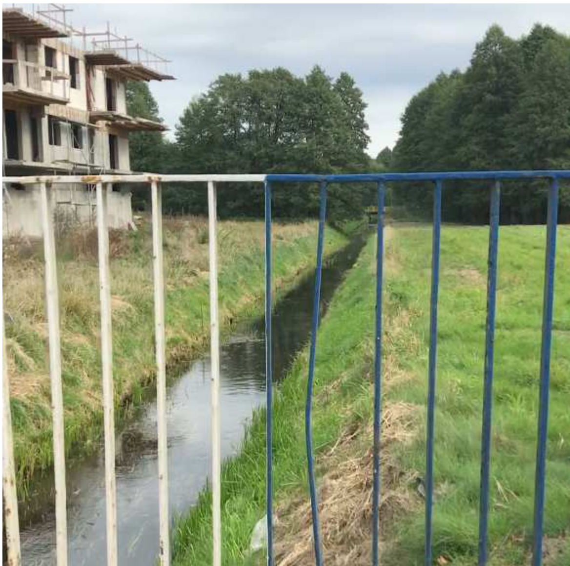
Fot. 5a. Budynek wielorodzinny w budowie przy ul. Starego Urzędu nad Czerską Strugą
