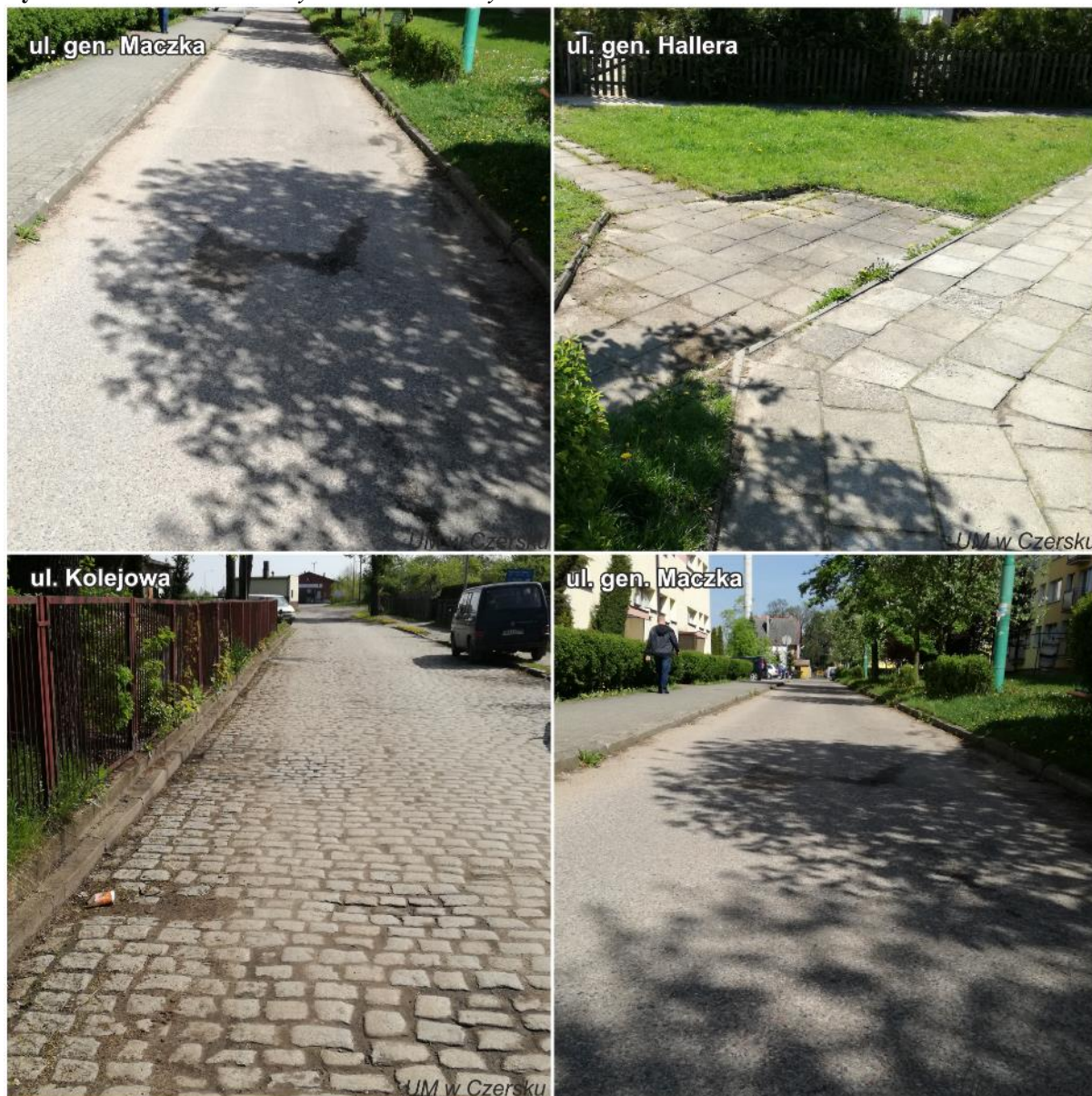
Ryc. 40. Ulice i chodniki w złym stanie technicznym
