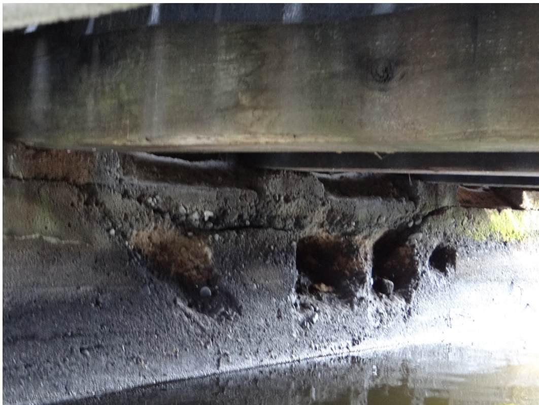
Rysunek 4. Ubytki betonu w podporze pośredniej.
