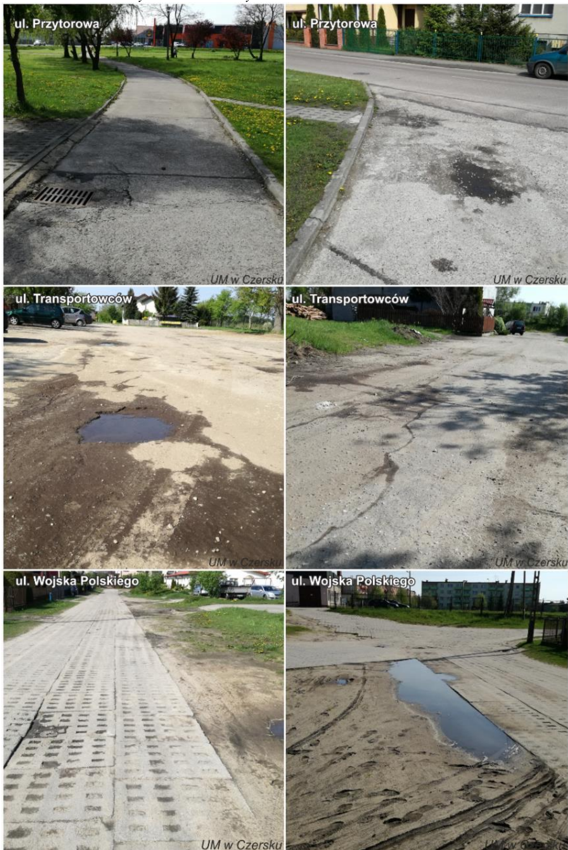
Ryc. 39. Ulice i chodniki w złym stanie technicznym
