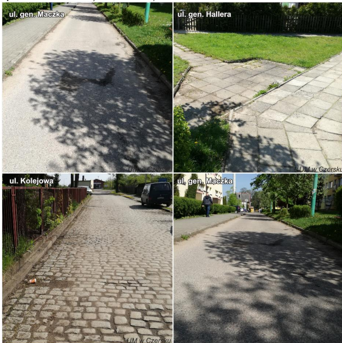
Ryc. 40. Ulice i chodniki w złym stanie technicznym
